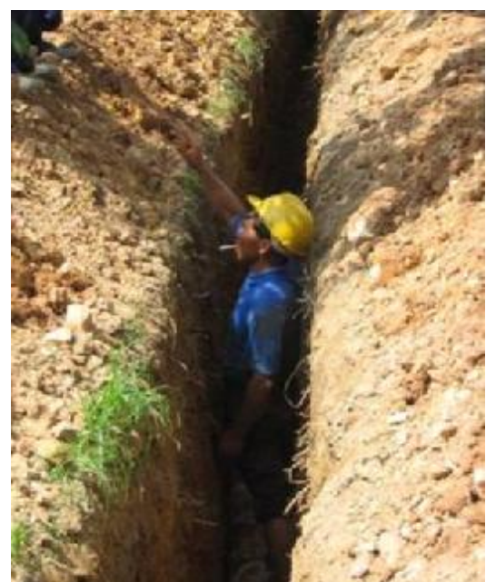
图4 燃气工程沟槽开挖常见不安全现象图片2
