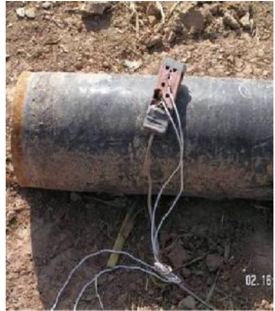
图2 燃气工程临时用电常见不安全现象2
