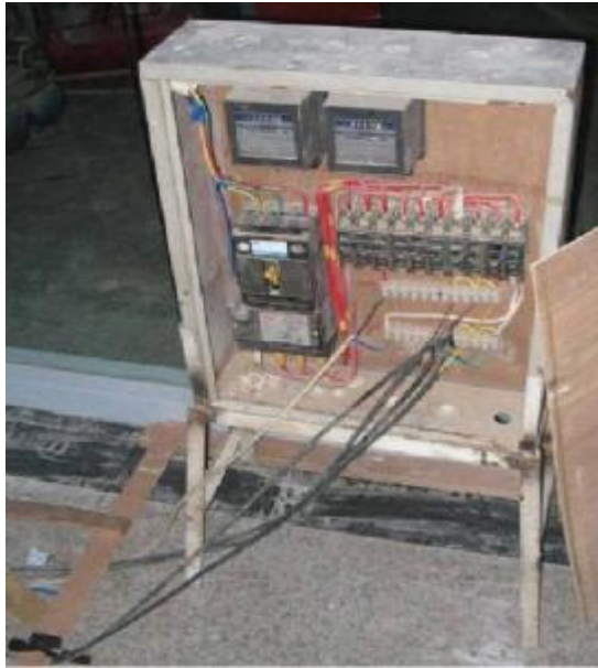
图1 燃气工程临时用电常见不安全现象1
