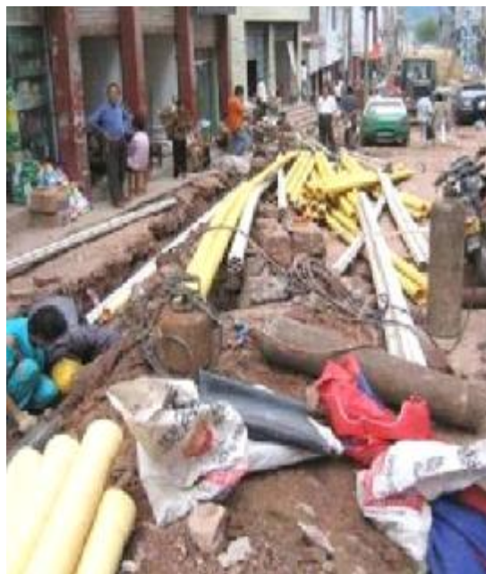
图3 燃气工程沟槽开挖常见不安全现象图片1
