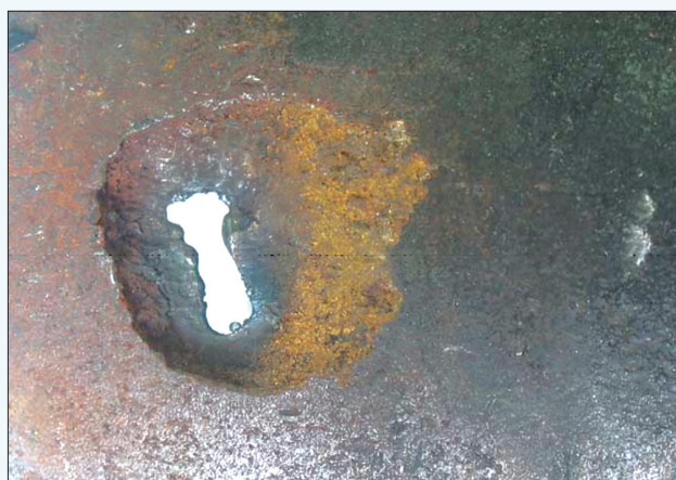
图3 杂散电流造成的腐蚀穿孔
