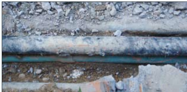
图2 春晖路9组10栋西侧庭院管网防腐层胶带破损、剥离、漏铁
