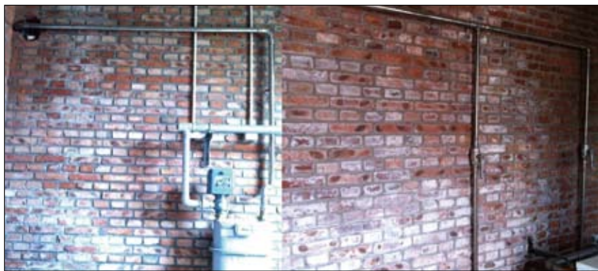
图为通州大红大紫会所燃气管道实景
