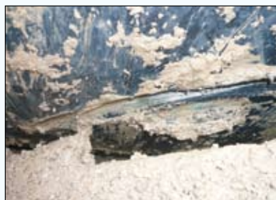
图14 被钻头划伤的高压A燃气管线
