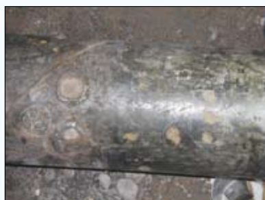
图15 开挖后腐蚀严重的次高压A管线
