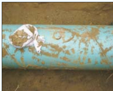
图10 被钻漏的高压B燃气管线
