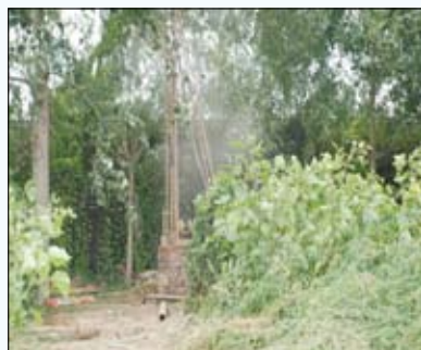
图9 钻漏高压B管线的事发现场
