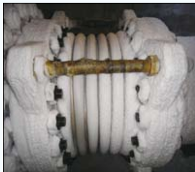
图3 闸井内设备表面结霜
