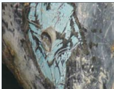
图11 被钻漏的燃气管线
