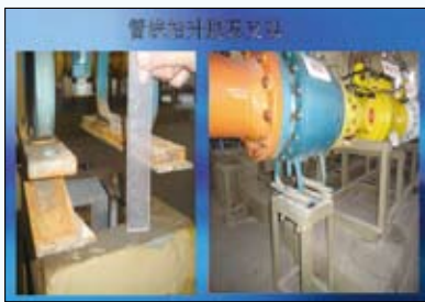
图8 调压支线上的截门整体脱离支架
