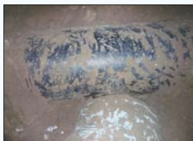
图13 在运的高压A燃气管线
