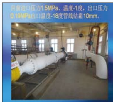
图4 调压站中压管道表面结霜
