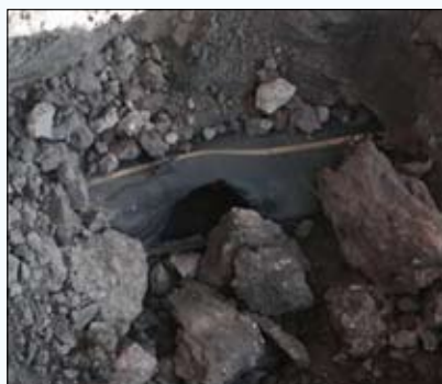
图2 聚乙烯管道损伤
