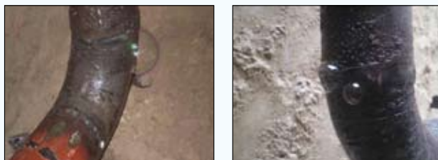
图6 钢塑转换接头钢质管道焊缝处漏气
