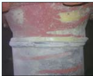
图9 聚乙烯管道焊缝错边
