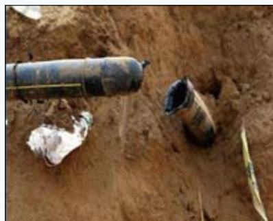
图3 聚乙烯管道挖断
